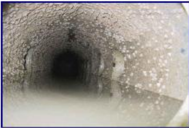
Tropik ortam şartlarında Paslanmaz Çelik 316L deniz suyu girişinde 1 yıl sonraki biofilm, deniz canlıları ve korozyon oluşumu
